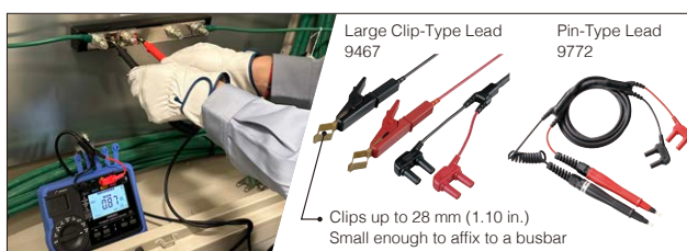
Prova continuità dei conduttori (@200mA)
